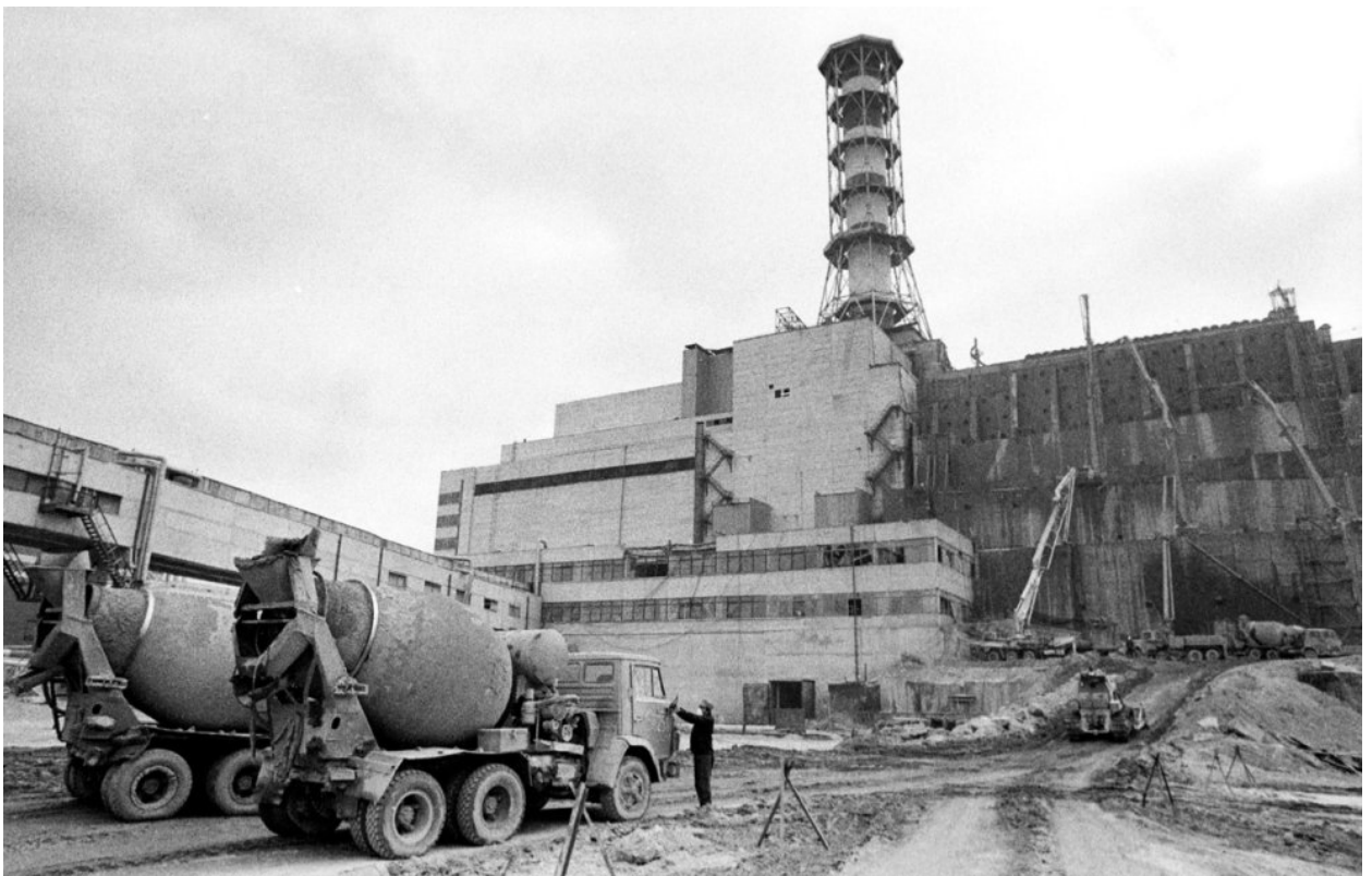
Жовтень 1986 року. Вантажівки з цементом на будівельному майданчику по створенню «саркофага» над 4-м реактором Чорнобильської АЕС, що вибухнув. (Фото Reuters)
